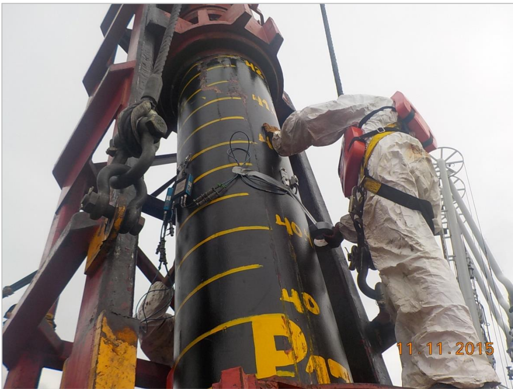
Figura 3. Par de sensores instalado (deformímetro – acelerómetro)
