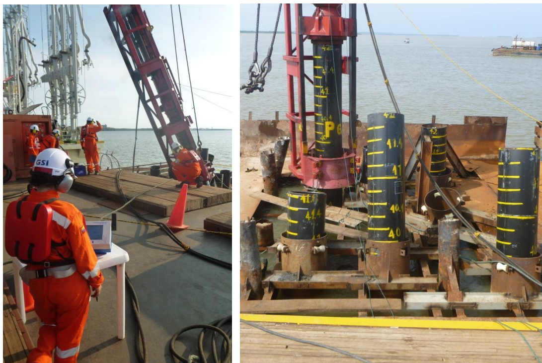
Figura 1. Vistas generales del monitoreo de hincado y del desarrollo de una prueba de carga PDA
